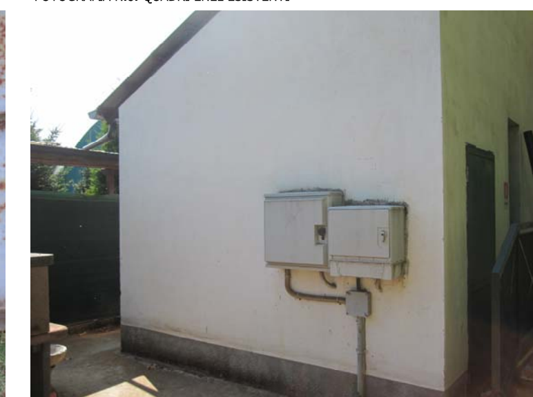
FOTOGRAFIA N.8: QUADRI ENEL ESISTENTI
