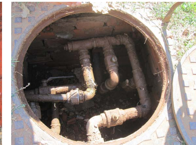
FOTOGRAFIA N.6: POZZETTO IMPIANTO IRRIGAZIONE CAMPI DA TENNIS ESISTENTE
