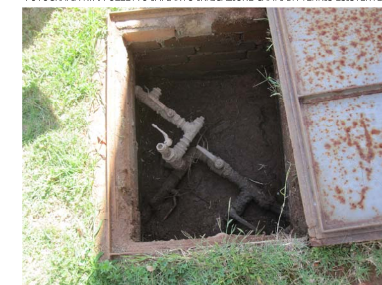
FOTOGRAFIA N.7: POZZETTO IMPIANTO IRRIGAZIONE CAMPI DA TENNIS ESISTENTE
