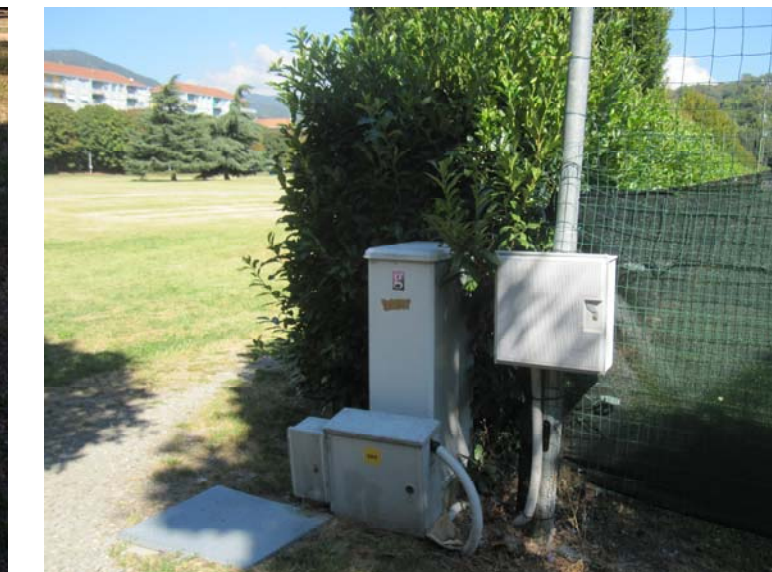
FOTOGRAFIA N.2: QUADRI ENEL ESISTENTI
